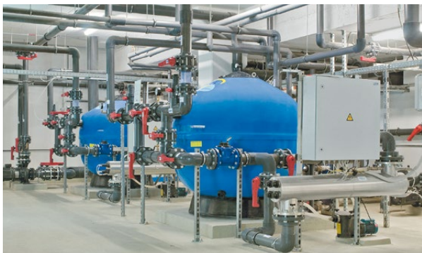
Бассейн, Венгрия, г. Дунайварош, 1 000 м 3 /ч
