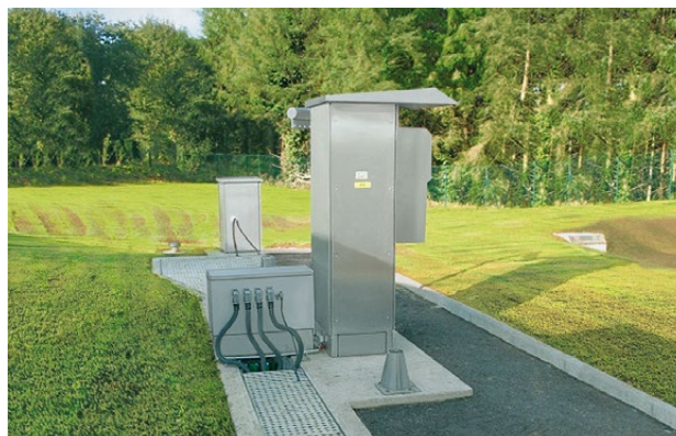
Оборудование «МЮРРЕЙ» ОСК, Франция, г. Шатолин, 8 400 м 3 /сут
